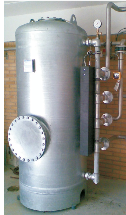
Arsenentfernung durch Adsorption in einem Wasserwerk. Die Anlage besteht aus einem automatischen Druckfilter Typ NSB 170, der nach offenen Filtern eingebaut ist. Die Durchsatzleistung beträgt 12 m 3 /h.
