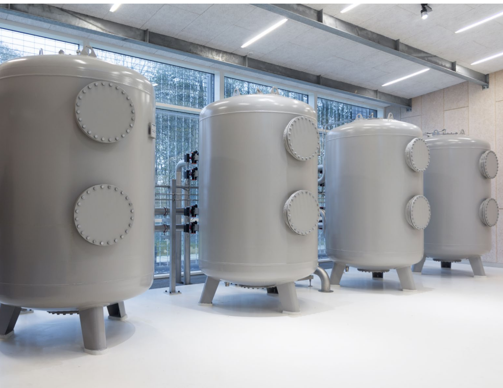
Reduzierung von Eisen, Mangan und Ammonium in einem Wasserwerk. Durchsatzleistung: 2 x 30 m 3 /h.
